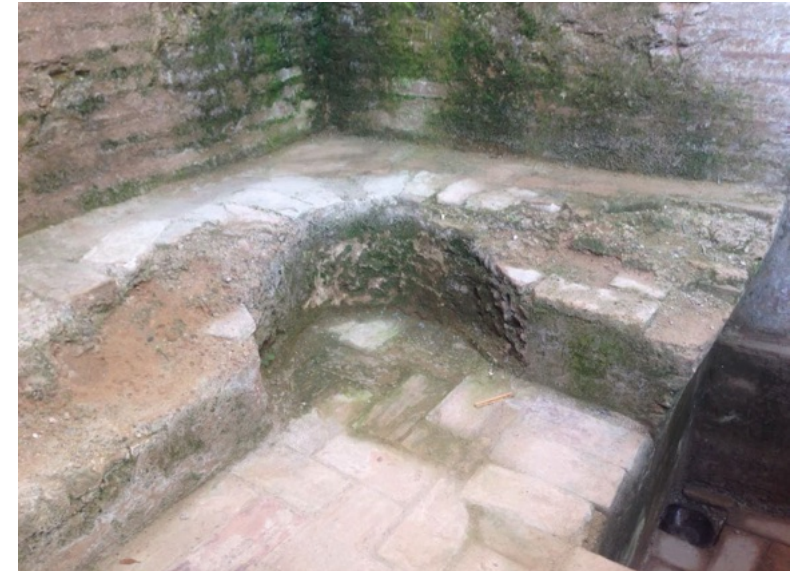
Proliferación biológica y ausencia de ladrillos y mortero en parte de la bancada.
