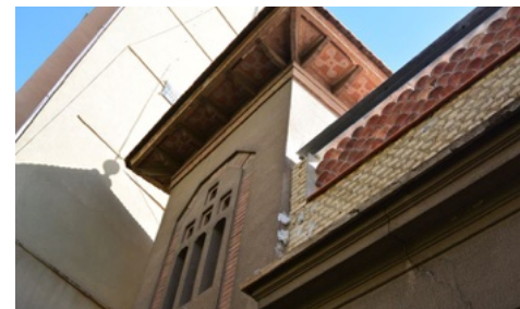
Detalle de la decoración del torreón del pabellón de la fábrica. Foto: Paloma Berrocal Ruiz
