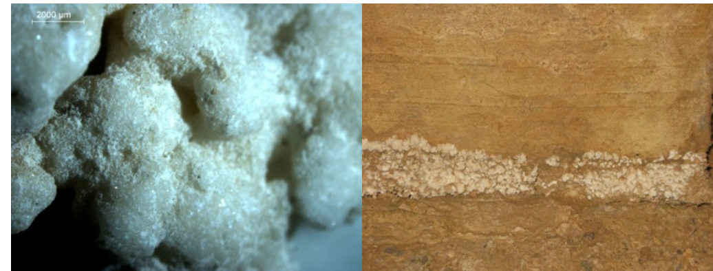
Recristalización de sales, seguramente sulfato de calcio. Especialmente presente en el arranque de la bóveda. En el detalle de un fragmento de sulfato de calcio, extraído de las sales precipitadas, observamos, a modo de estalactita, una presencia continua de humedad provocada por un goteo lento y prolongado que deriva en la formación sales insolubles.
